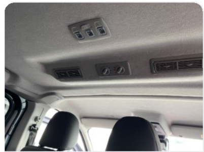
Tyłny nawiew centralny
